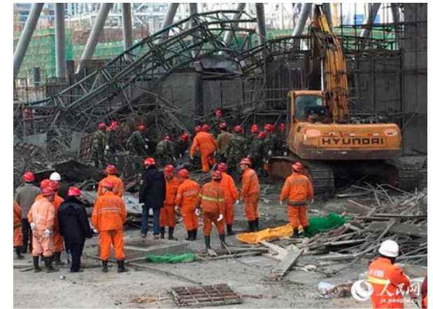
▲江西丰城在建冷却塔施工平台倒塌，上图为救援人员在事故现场。
