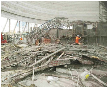
图：2016年江西丰城电厂在建冷却塔施工平台倒塌，现场一片废墟。
